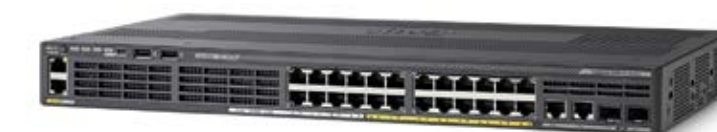
Uno degli switch CISCO Catalyst 2960 utilizzati per la sala NOC.
