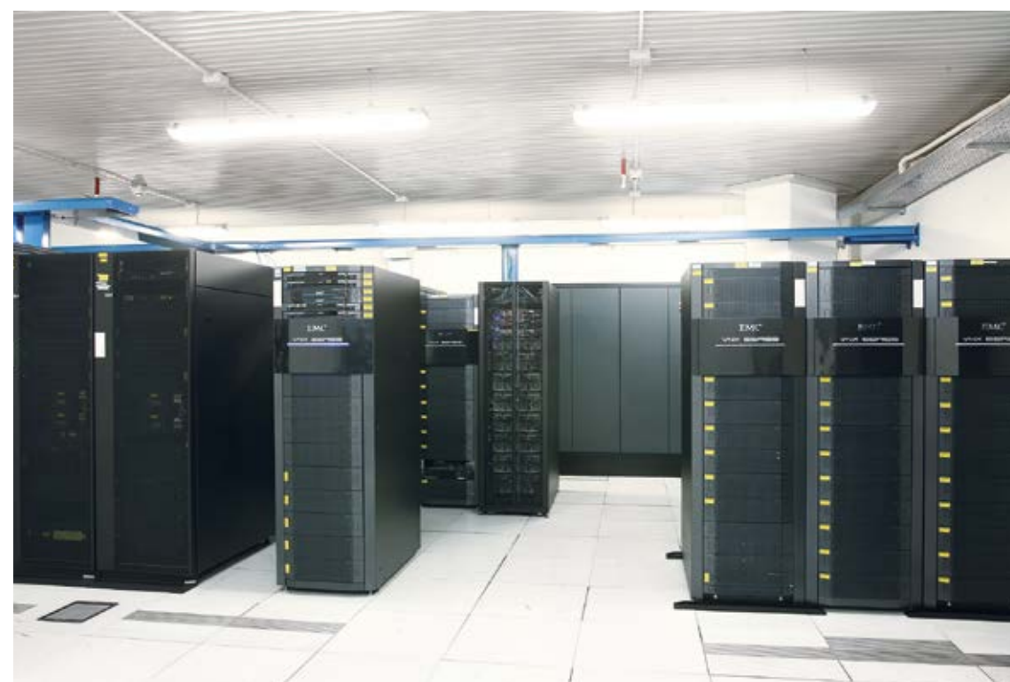
Qui sopra, una delle sale dedicate ai server in cui ci è stato possibile accedere (molte sono off-limits per questioni di sicurezza) nei piani interrati.
